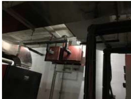
锅炉房墙体穿孔板共振吸声结构吸声
