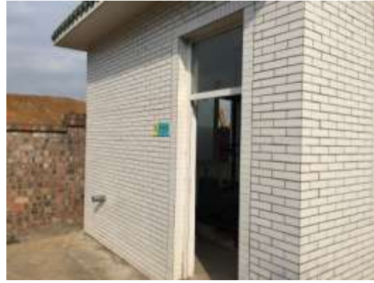
污水处理站风机房建筑物隔声
