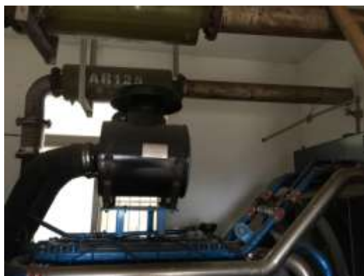
柴油发电机尾气净化装置
