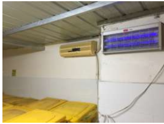
住院综合楼医疗废物暂存间内紫外消毒装置
