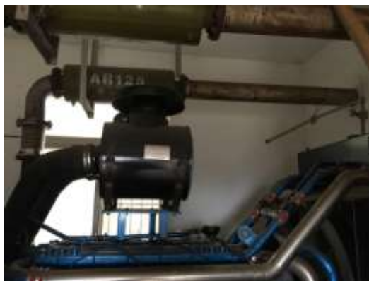
柴油发电机尾气净化装置
