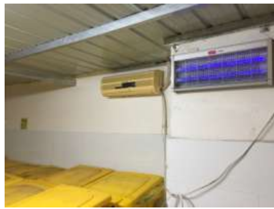
医疗废物暂存间内紫外线消毒装置
