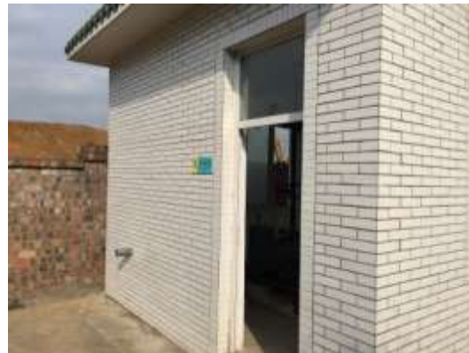
污水处理站风机房建筑物隔声
